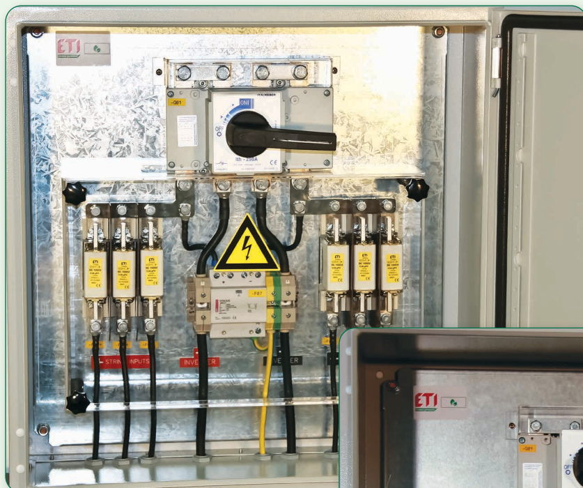
Rozdzielnica DC (wkładki NH gPV)
